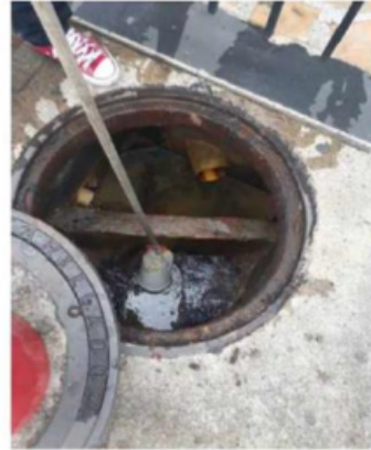
Figura 2 Realizando la toma de muestras en la caja de inspección vertimiento final
