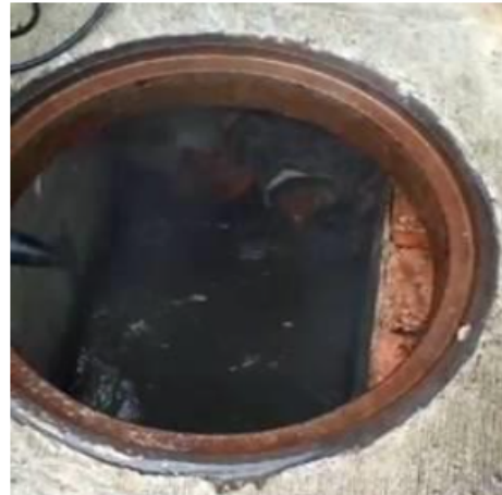
Imagen 7. Trampa de Grasas y Sólidos
